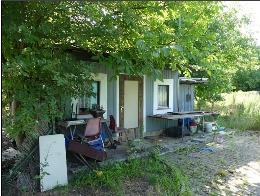
Abb. 11: Gartenhütte im südlichen Teil des alten Geltungsbereichs, potenzielle Quartierstandorte für Fledermäuse und potenzielle Niststandorte für Vögel (21.07.2020)
